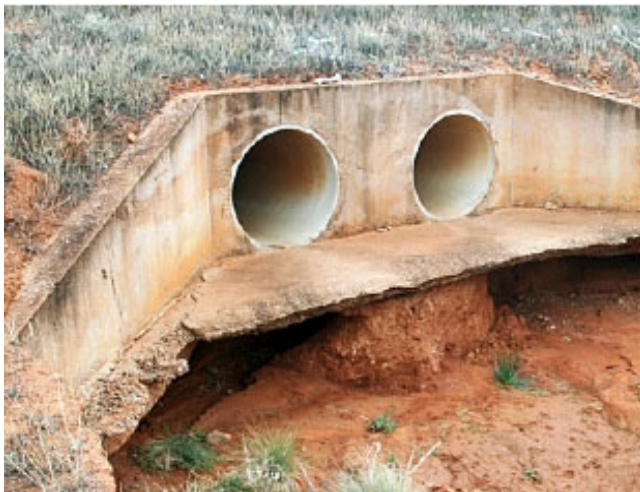
підмив вихідного отвору
