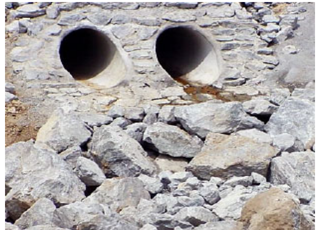
нераціональне розміщення кам'яної насипки
