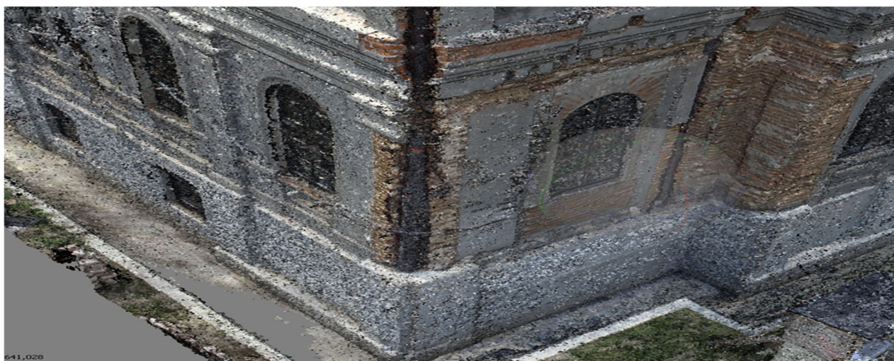
Рисунок 8 – 3D-хмара пошкодженої частини будівлі Figure 8 – 3D cloud of damaged part of building
