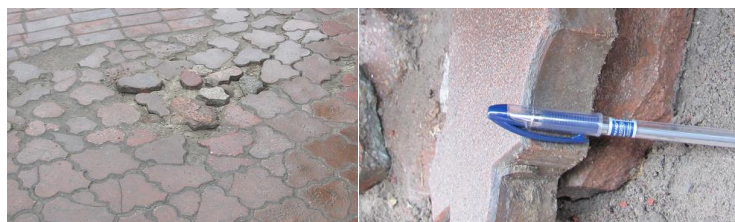
Рисунок 1 – Руйнування, що спровоковані малою товщиною елементів мощення
