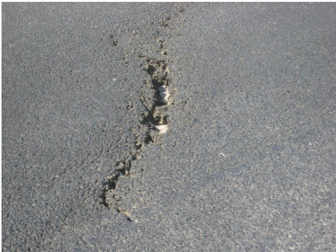
Рисунок 10 – Повреждение дорожной одежды, вызванное нарушением ее сцепления с плитой проезжей части
