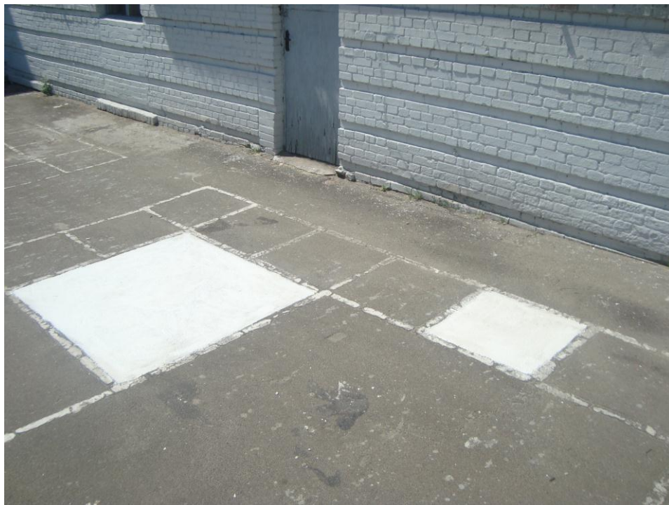
Рис. 6. Зафарбовані ділянки асфальтобетонного покриття
