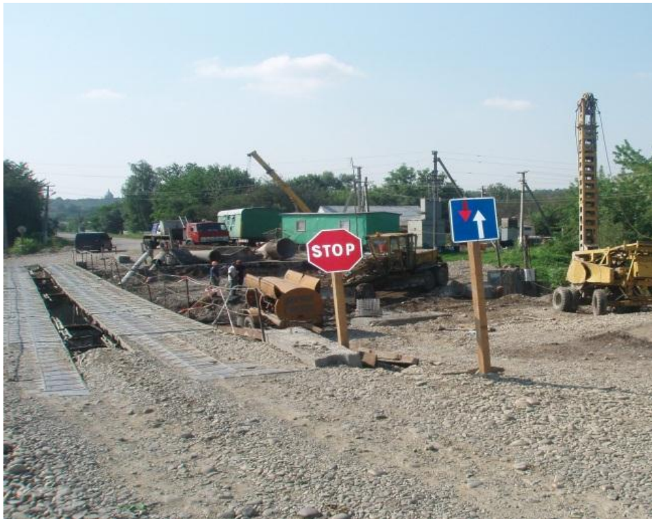
Рисунок 4 – Зруйнований міст через потік у с.Ілінці, Івано-Франківська обл. (йде будівництво нового моста)
