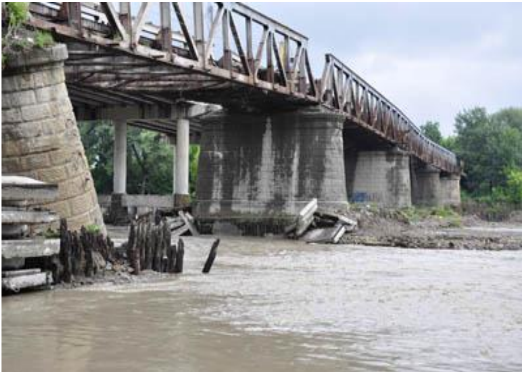
Рисунок 2 – Розмив дна біля мостових опор на р. Прут, м.Чернівці
