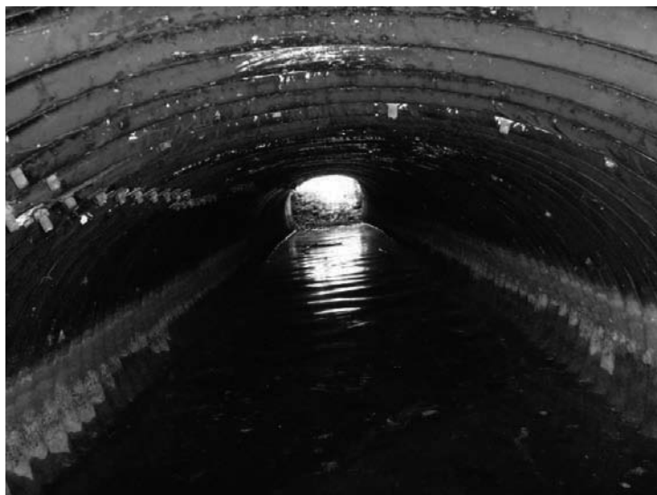
Рисунок - 3 Овализация тела трубы
