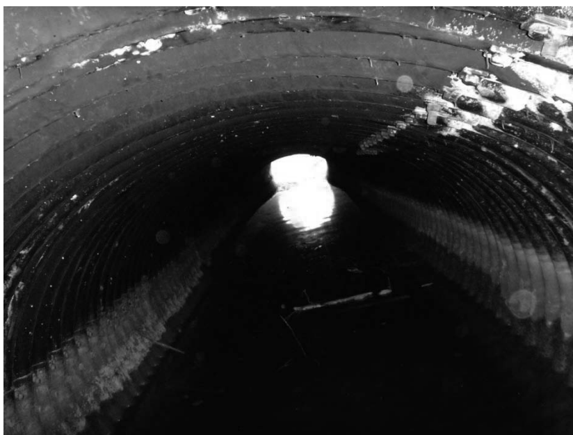
Рисунок - 2 Прогиб железнодорожной трубы
