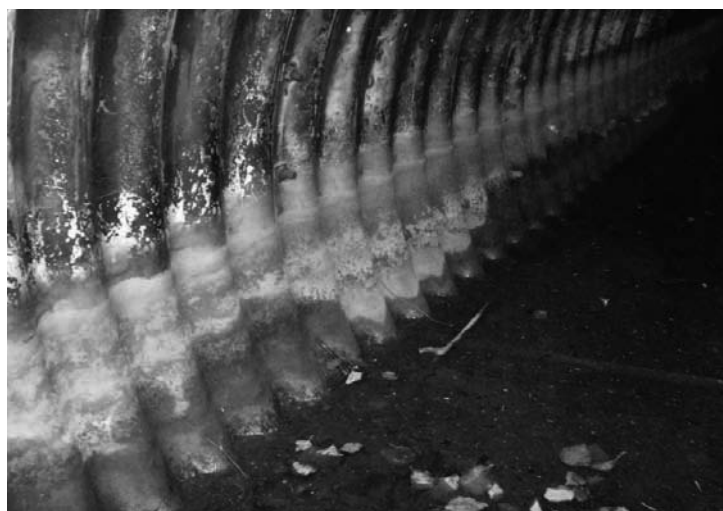
Рисунок - 4 Нарушение обмазочной гидроизоляции и коррозия
