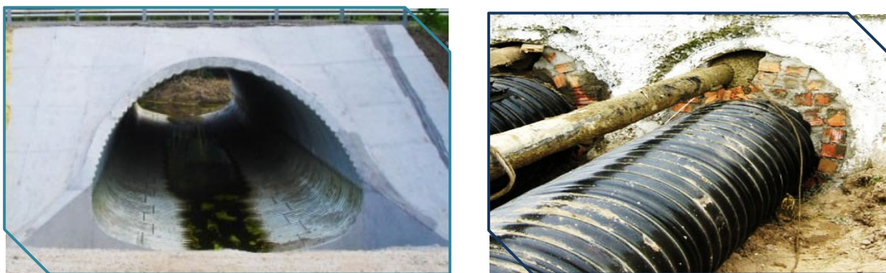
Рисунок 1 – Підсилені пошкоджені споруди методом гільзування із використанням металевих гофрованих конструкцій та труб
