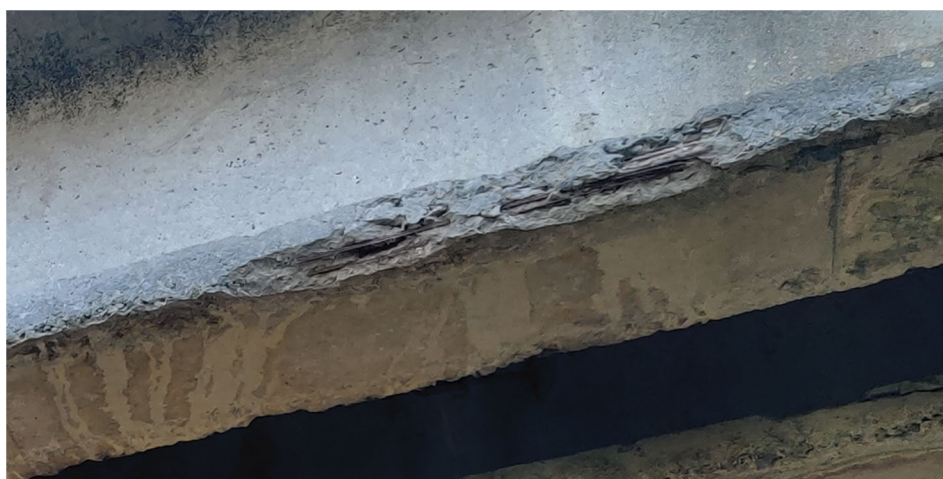
Рисунок 3 — Руйнування захисного шару бетону із оголенням та корозією струн Figure 3 — Failure of the concrete protective layer with exposure and corrosion of the strings
