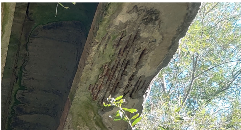
Рисунок 4 — Руйнування захисного шару бетону із оголенням та корозією струн спричинене інтенсивним замоканням бетону та недостатньою товщиною захисного шару бетону Figure 4 — Failure of the concrete protection layer with exposure and corrosion of the strings caused by intensive wetting of the concrete and insufficient thickness of the concrete protection layer
