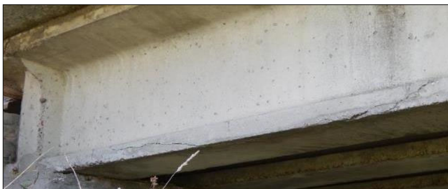
Рисунок 1 — Силлові тріщини в тілі балки прогонової будови Figure 1 — Force cracks in the beam body of a span structure
