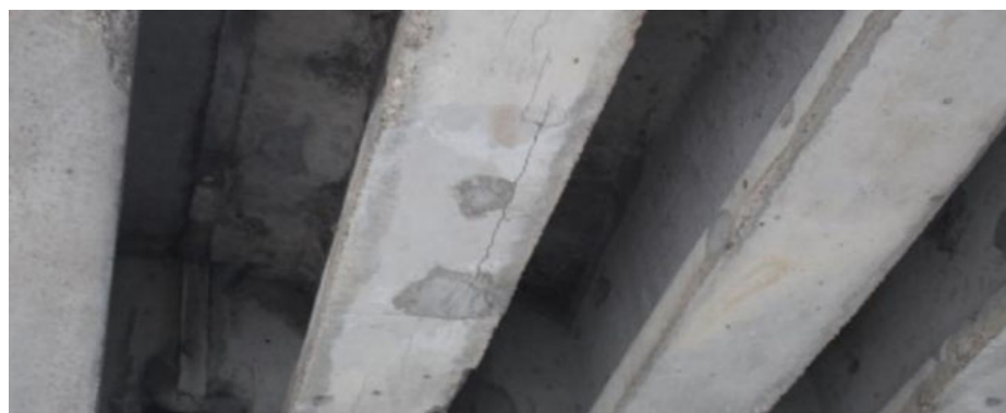
Рисунок 2 — Тріщини на нижній грані балки прогонової будови, утворені внаслідок корозії арматури Figure 2 — Cracks on the lower face of a girder beam in a span structure caused by corrosion of reinforcement
