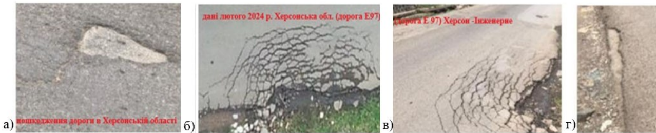
Рисунок 4 – Виявлені в результаті військових дій пошкодження на дорозі E 97 (а) – вибоїна на дорозі, б), в) г) – пошкодження краю дороги)
