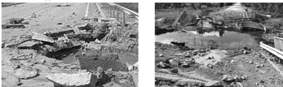
Рисунок 1 – Найбільш часті пошкодження доріг при військових діях Figure 1 – Most frequent road damage during military operations
