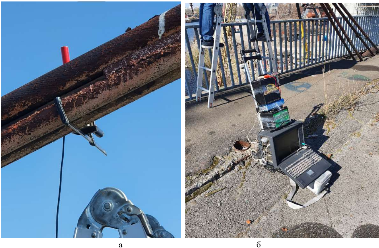
Рисунок 4 – а – Давач динамічних коливань встановлений на ванті; б – Програмно-технічний комплекс для аналізу динамічних коливань
