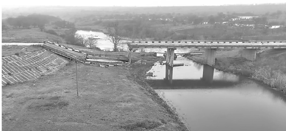
Рисунок 4 – Загальний вигляд зруйнованого мосту в Херсонській області. Figure 4 – General view of destroyed bridge in Kherson region.
