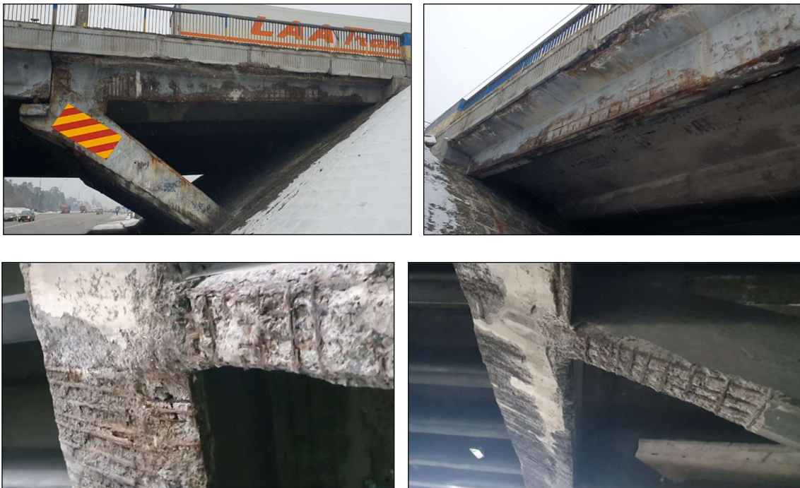
Рисунок 3 – Тріщини, сколи бетону з оголенням та корозією арматури рамної конструкції шляхопроводу
