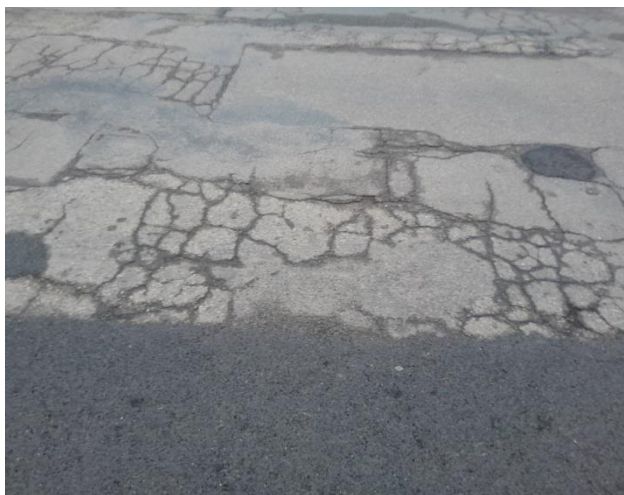
а) вигляд стику між стрим покривом та новим шаром холодного асфальтобетону
