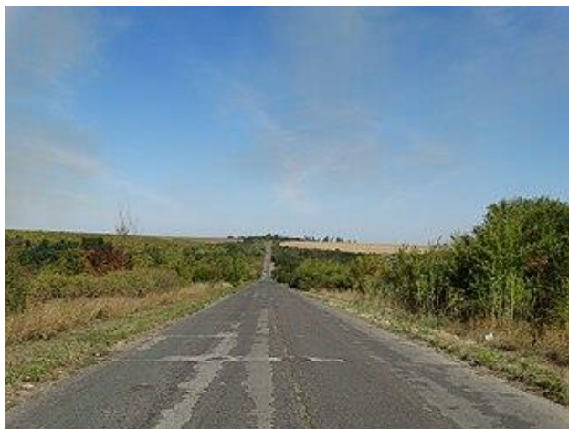
Рисунок 1 – М-13 Стан покриття Figure 1 – M-13 Pavement Condition
