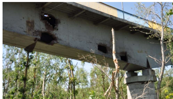
Рисунок 11 – Руйнування снарядами балки мосту
