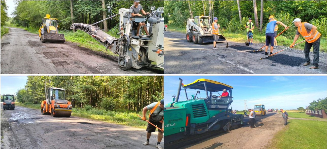
Рисунок 4 – Ліквідація дефектів дорожнього одягу на дорозі Т-18-17 (на фото роботи виконує ПрАТ «Рівнеавтошляхбуд», серпень 2024р.)
